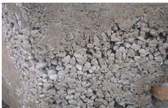
Рисунок 3 - Раковины в железобетонных монолитных фундаментных стенах
