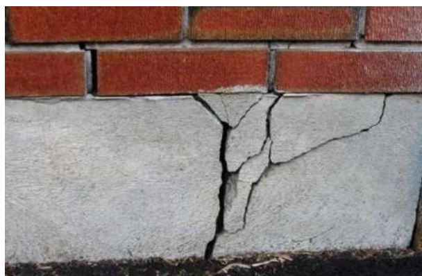
Рисунок 4 - Трещины в фундаментных стенах
