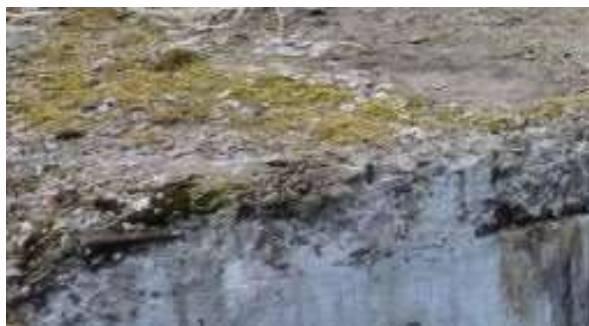
Рисунок 8 - Биопоражения на бетонной поверхности фундамента
