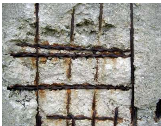
Рисунок 6 - Выбоины и углубления в бетоне
