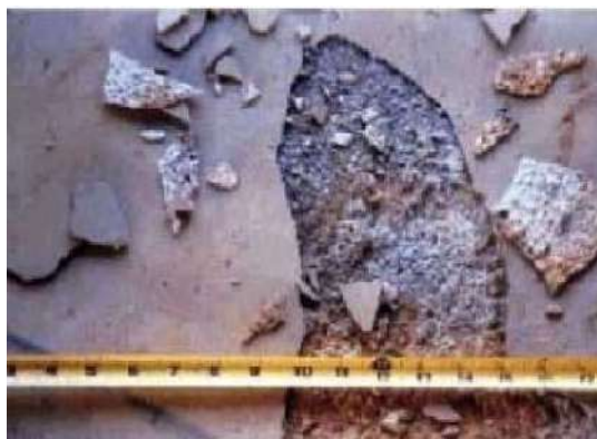
Рисунок 5 - Расслоение железобетонной конструкции
