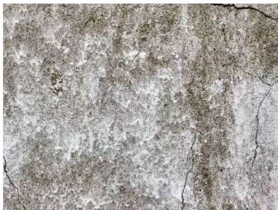
Рисунок 7 - Высолы на бетонной поверхности фундамента
